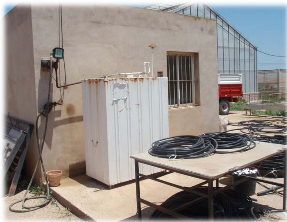
Deposito suministro combustibles a vehículos
