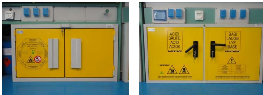
Figura 13. Armarios de seguridad para almacenamiento de productos inflamables
