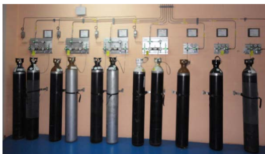
Figura 29. Instalación de gases técnicos
