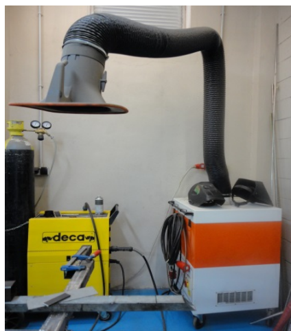
Figura 4. Campana de extracción localizada para sistema de soldadura
